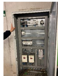
Variadors de freqüència d'una UTA de piscina
