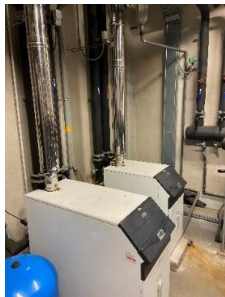
Calderes de gas natural
