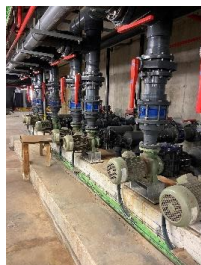
Banc de bombes de filtratge
