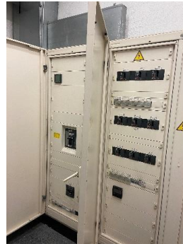
QGBT amb monitoratge
