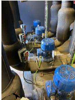
Bancada de bombament
