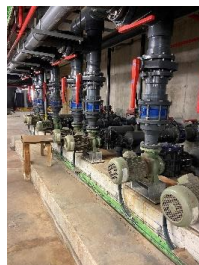
Banc de bombes de filtratge
